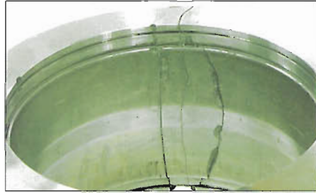
Fotografia 7-6-5 Część: Powierzchnia bieżni pierścienia zewnętrznego z fotografii 7-6-4 Symptom: Pęknięcie powierzchni zewnętrznej rozwijające się na bieżni
